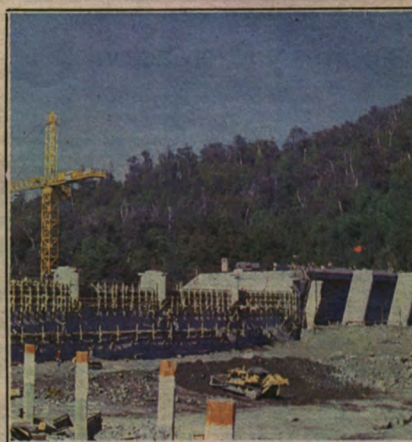
Central Colbún-Machicura. Su obra principal la constituye el embalse Colbún. La obra entrará en funciones en 1985, entregando al país cerca de 3.300 millones de KWH; casi un tercio de la producción anual de energía, e incrementando, además, la riqueza agropecuaria de Talca y Linares y favoreciendo el desarrollo del turismo en el país.
